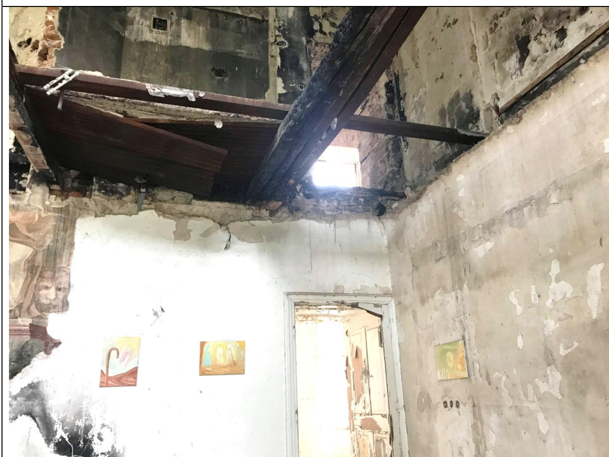
04 - Relikty klasicistního fabionového stropu s rákosovým podhledem v místnosti č. 3, 2.NP.
